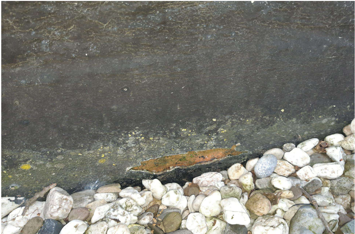
Foto 5. De vertinlaag is plaatselijk weggefallen t.p.v. het maaiveld.
