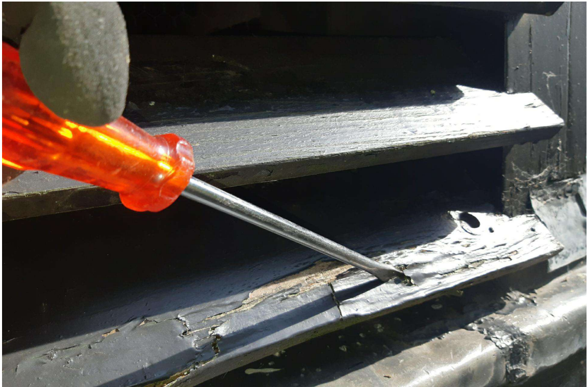
Foto 15. Galmbord plaatselijk aangetast door houtrot.
