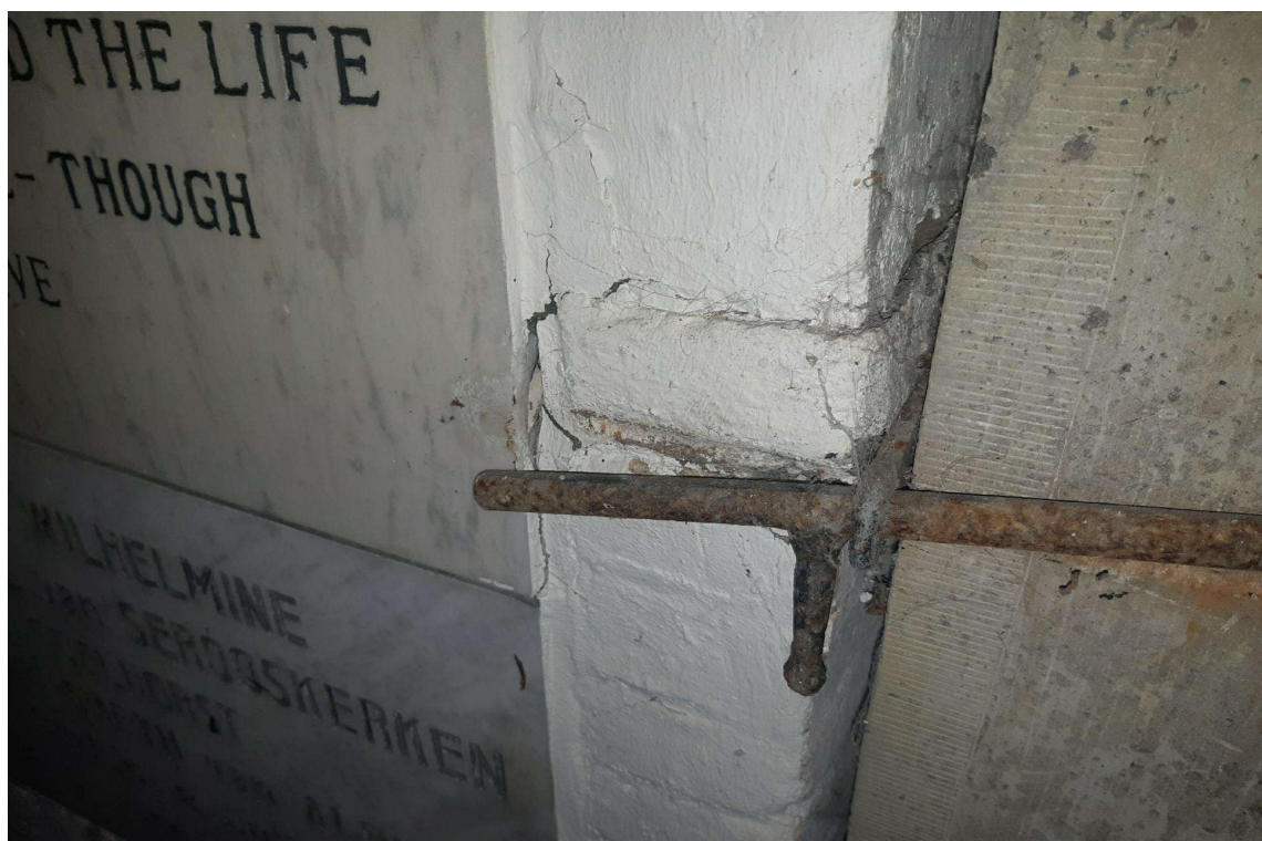
Foto 22. Metselwerk gebarsten/ gescheurd rond sluitwerk (linker graftombe).
