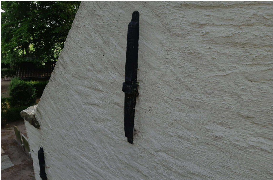
Foto 7. De verflaag begint af te bladderen.
