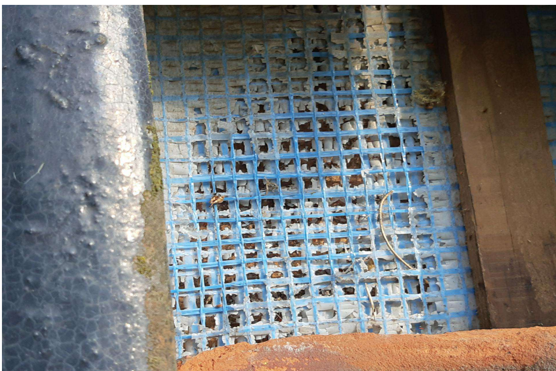
Foto 12. Dakfolie is aan het verteren.
