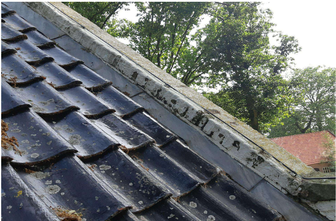
Foto 6. De vertinlaag is plaatselijk weggefallen bij de rollaag.
