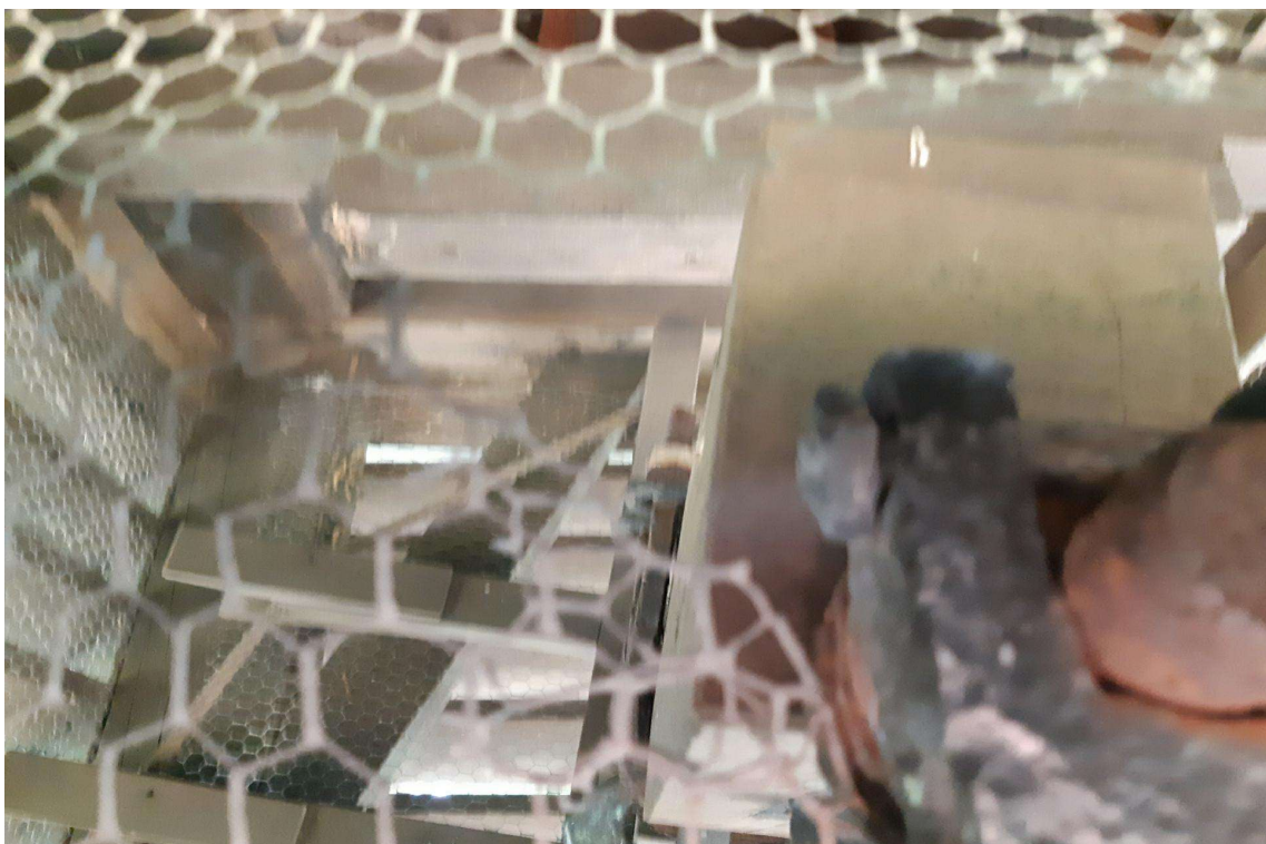
Foto 17. Het gaaswerk is plaatselijk beschadigd.
