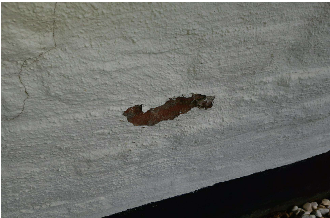
Foto 4. De vertinlaag is plaatselijk weggevallen.
