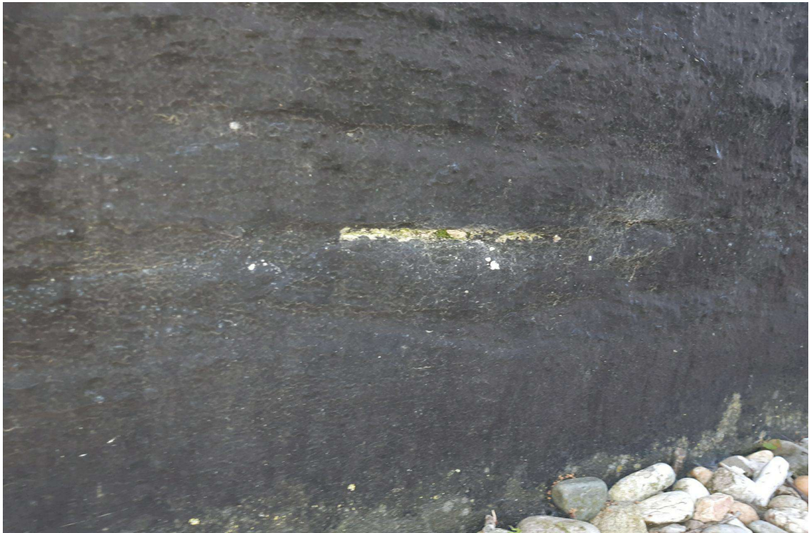
Foto 3. Enkel voegje weggevallen.
