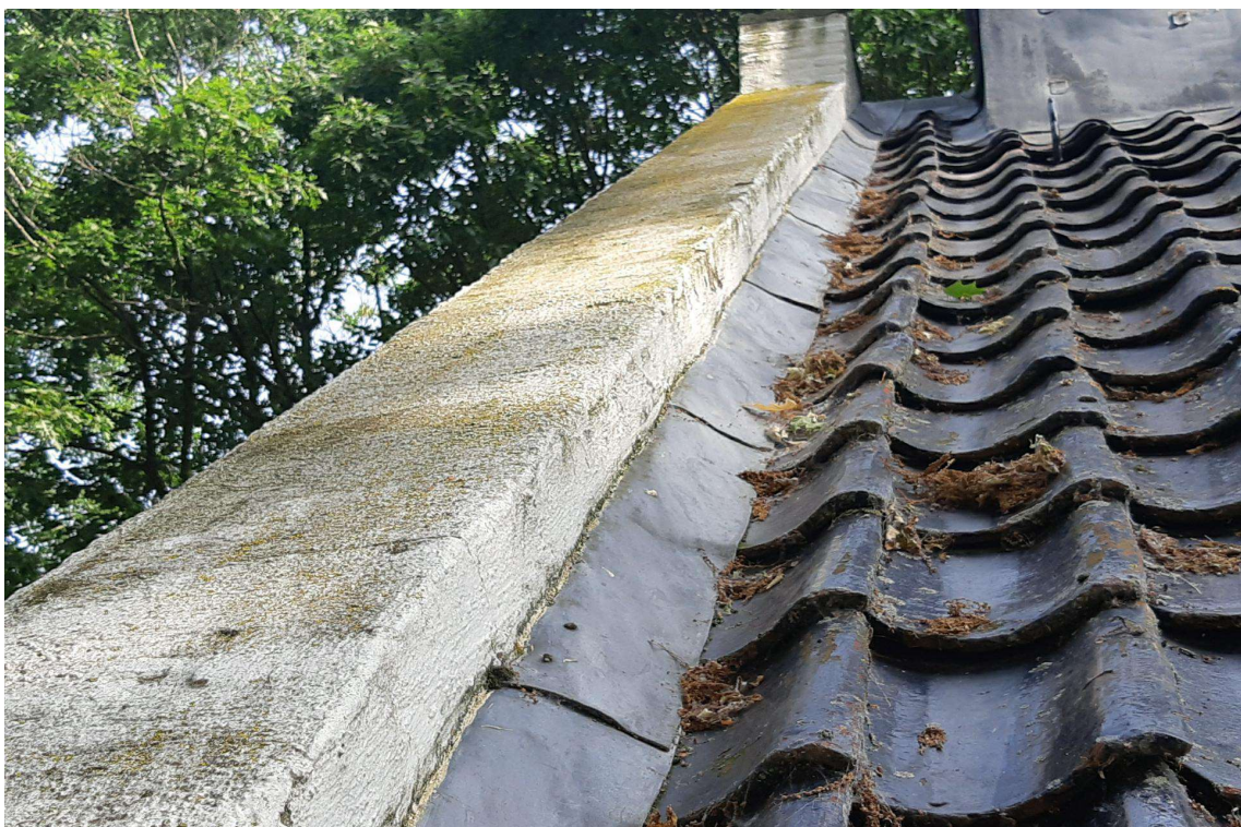
Foto 10. Muurverf is ernstig vervuild op de rollaag.
