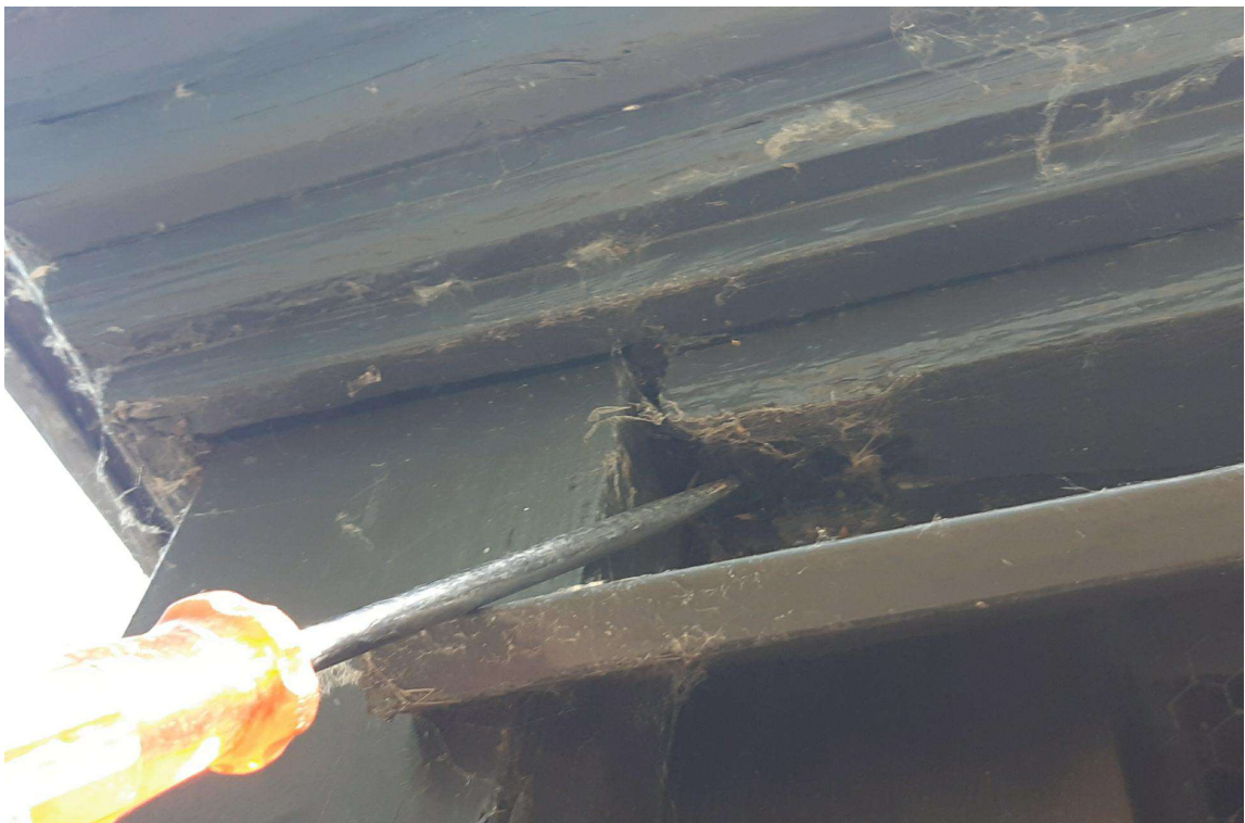
Foto 16. Galmbord plaatselijk aangetast door houtrot.
