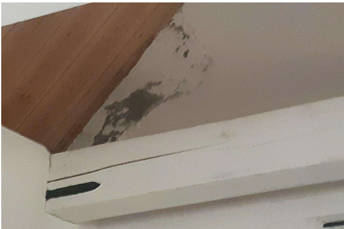
Foto 11. Muurverflaag bladdert plaatselijk af.
