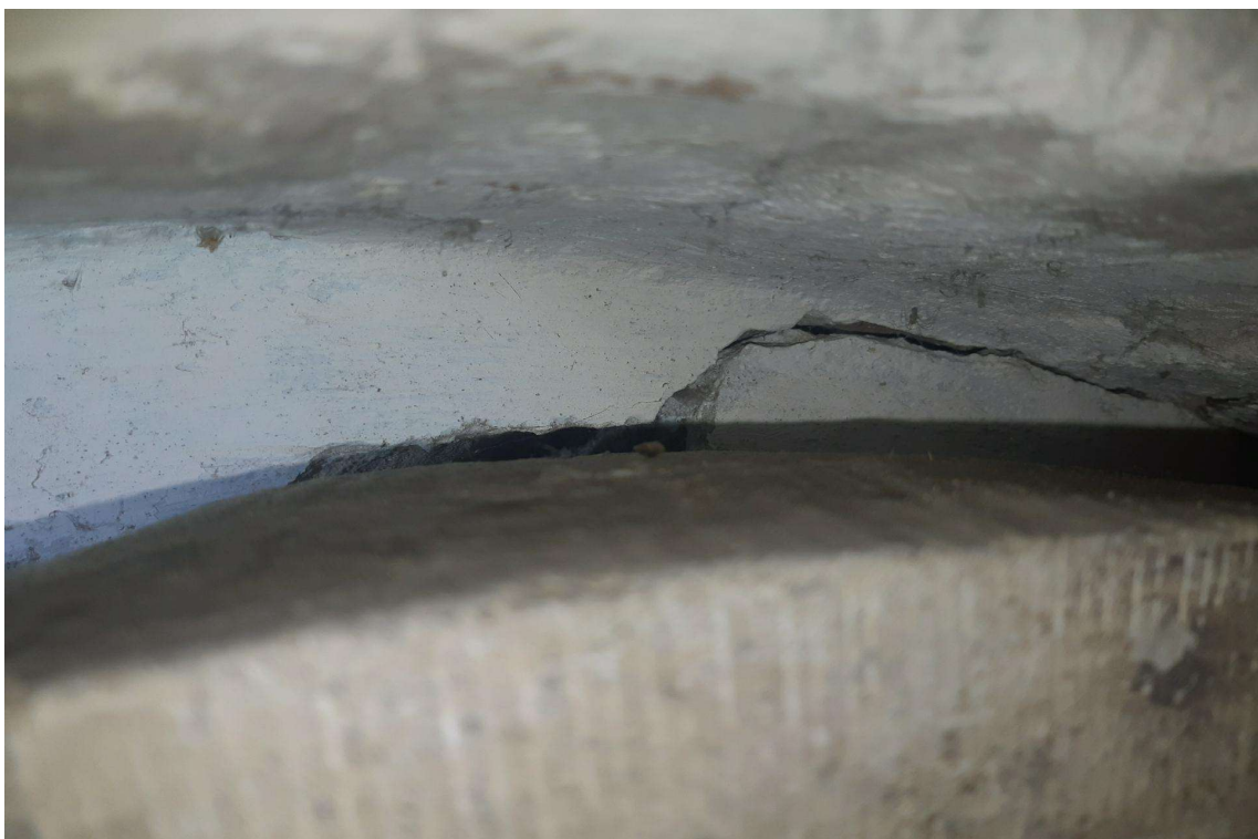
Foto 21. Metselwerk beschadigd door oproestend ijzerwerk (linker graftombe).
