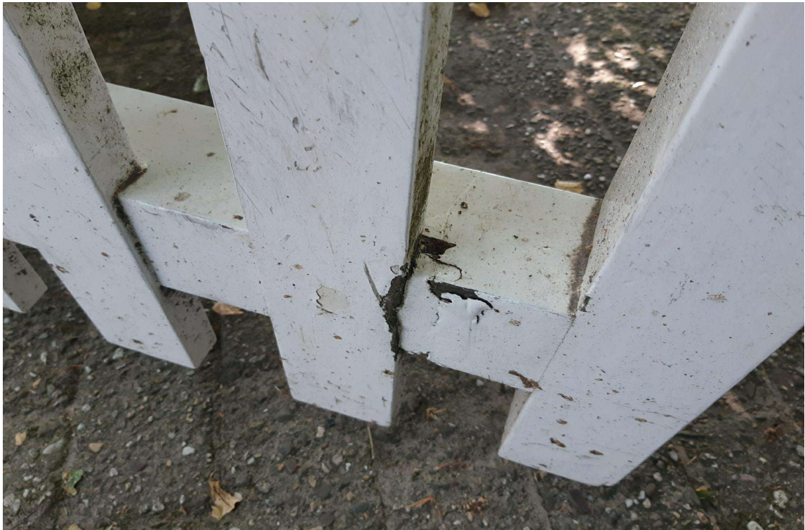
Foto 25. De verflaag begint af te bladderen.
